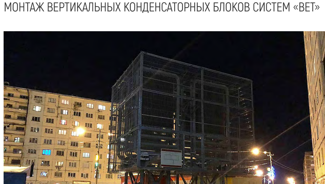
КОНДЕНСАТОРНЫЕ БЛОКИ СИСТЕМЫ «ВЕТ» С ЗАЩИТНЫМ ОГРАЖДЕНИЕМ
