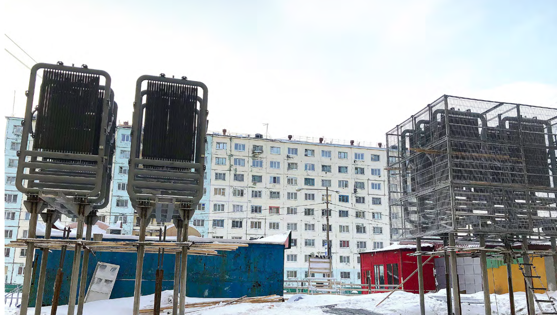
КОНДЕНСАТОРНЫЕ БЛОКИ СИСТЕМЫ «ВЕТ» С ЗАЩИТНЫМ ОГРАЖДЕНИЕМ
