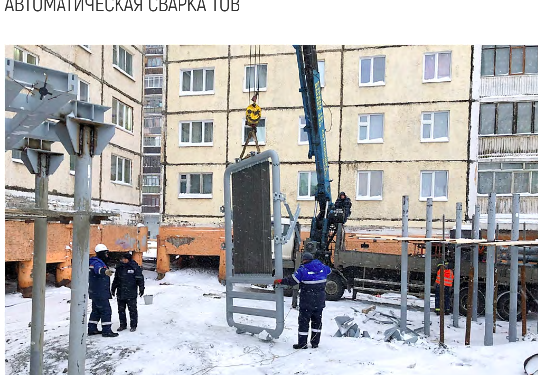
КОНДЕНСАТОРНЫЕ БЛОКИ СИСТЕМЫ «ВЕТ» С ЗАЩИТНЫМ ОГРАЖДЕНИЕМ
